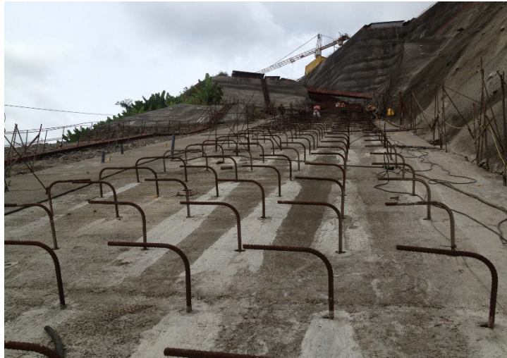
Figura n° 5. 20 Losa de nivelación y pernos plinto margen derecha PH Reventazón. Fuente: ICE, 2017.
