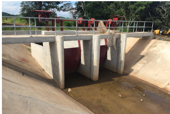
Figura n° 5. 49 Estructura de entrada sifón canal del Sur SENARA. Fuente: Imagen tomada de Internet, 2017.
