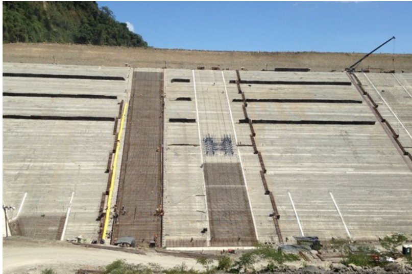
Figura n° 5. 23 Colocación de acero de refuerzo losas Cara en concreto, Presa P.H.R. Fuente: ICE, 2017.
